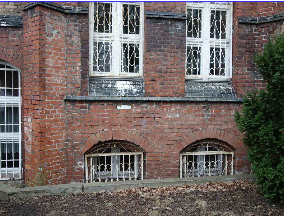
Przebarwione parapety skorodowane okratowanie
